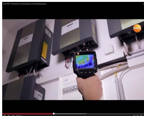
testo 870. Тепловизионное обследование электрооборудования
